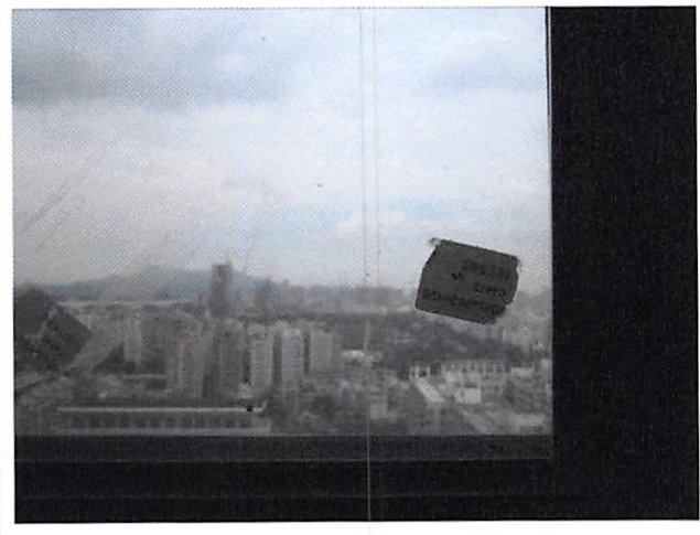
4. A座25楼楼梯间玻璃窗上有乱贴现象
