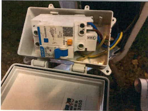
漏电开关照片
