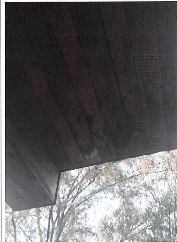
7. 木构岗亭（4号岗楼）屋顶有腐蚀
