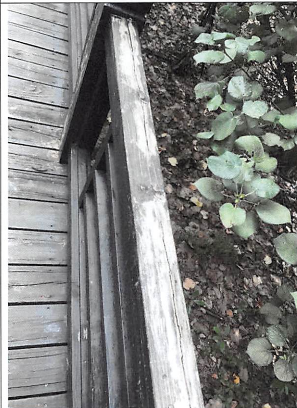
5. 木扶手护栏面漆有脱落
