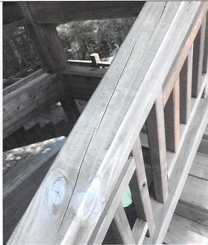
8. 木扶手护栏有开裂暂未修复
