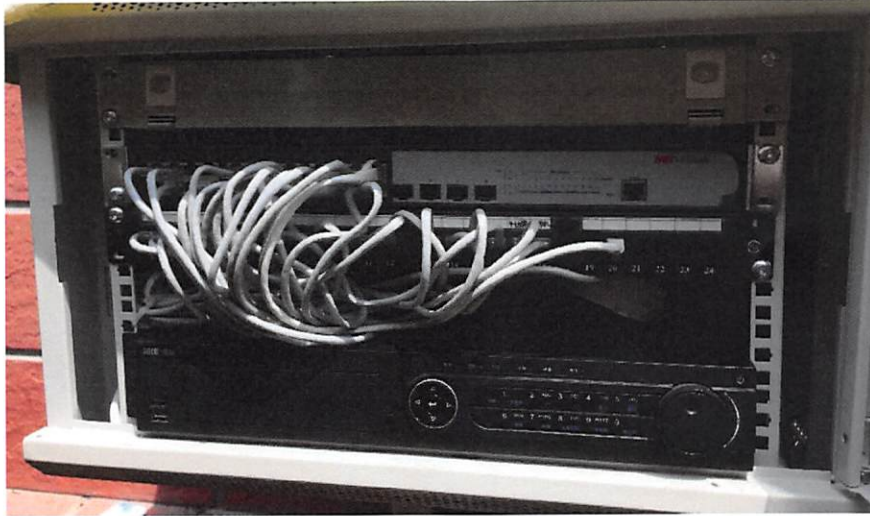
机柜 (内含硬盘录像机、以太网交换机)
