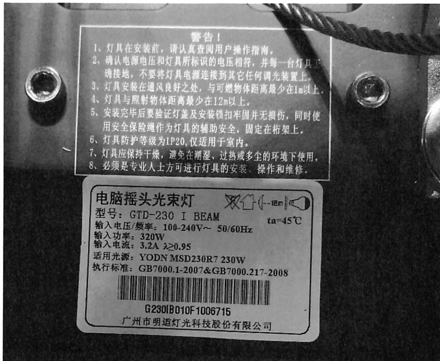
230W 电脑摇头光束灯铭牌
