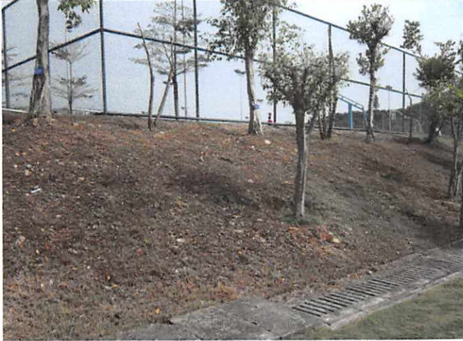
5. 学生餐厅北侧斜坡黄土裸露
