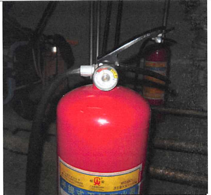
6. 工具仓库内有一瓶消防灭火器压力不足
