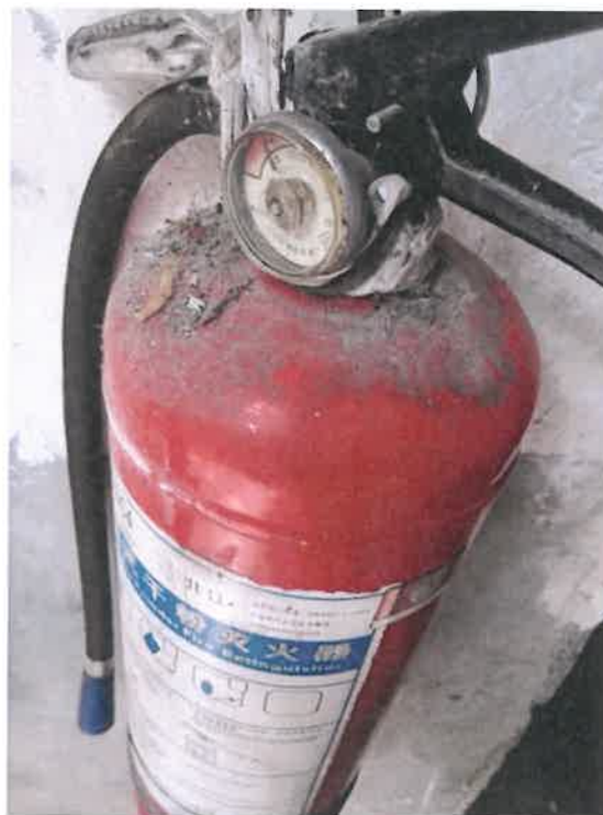
员工宿舍灭火器配置不足，1 灭火器失效
