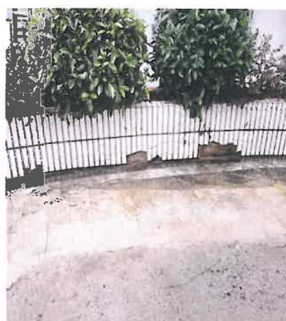
变电房通道两侧磁砖脱落 8 处
