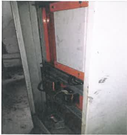
控制柜未使用隔板
