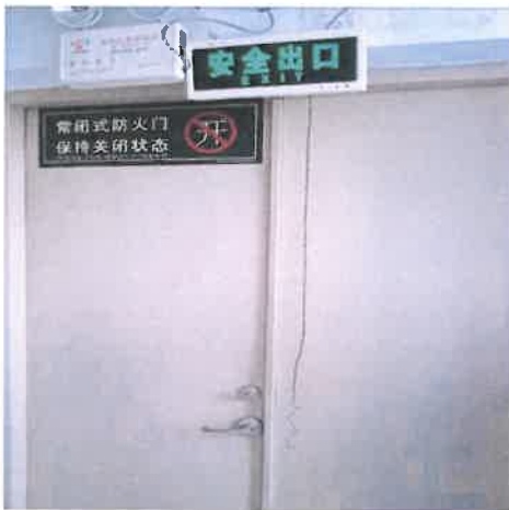
爱卫大厦 7 楼西侧疏散通道门用铁丝封死 问题点 3.
