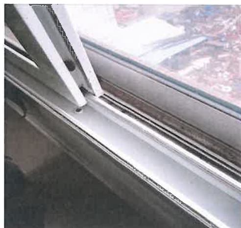
爱卫大厦 721 房间窗口有较厚灰尘
