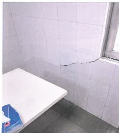
C106、C105 餐厅墙体开裂
