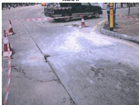
路面破块下坑，脱修
