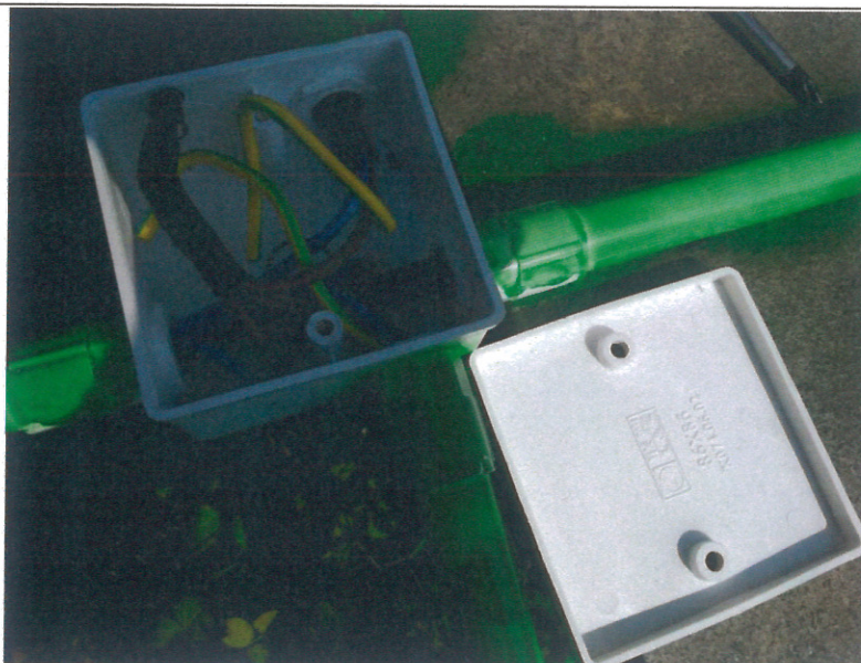
图 2 接线盒未采用防水措施
