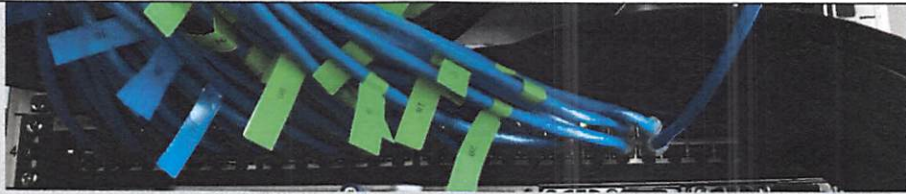
高速网络交换配套线缆接线
